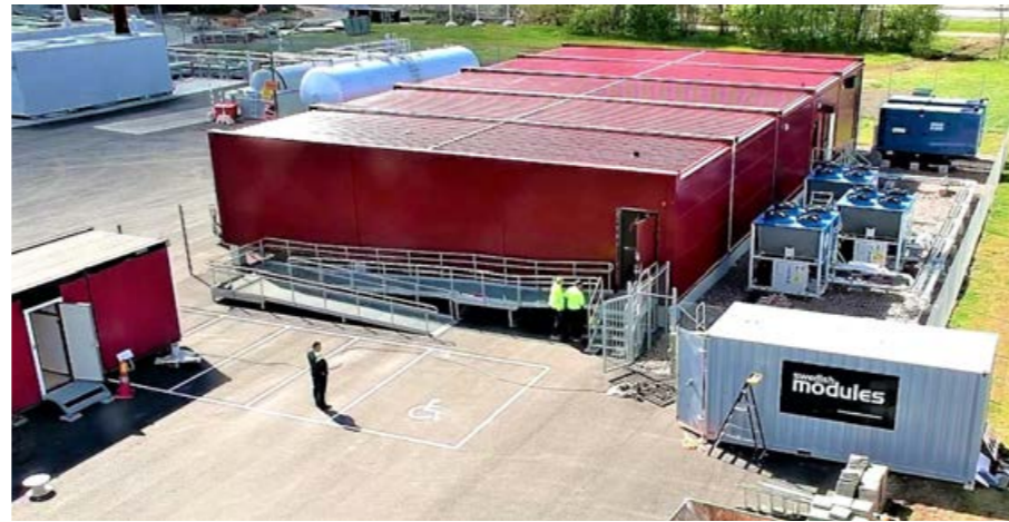
Datacentermoduler i Backa, Göteborg. Foto Göteborg Energi
