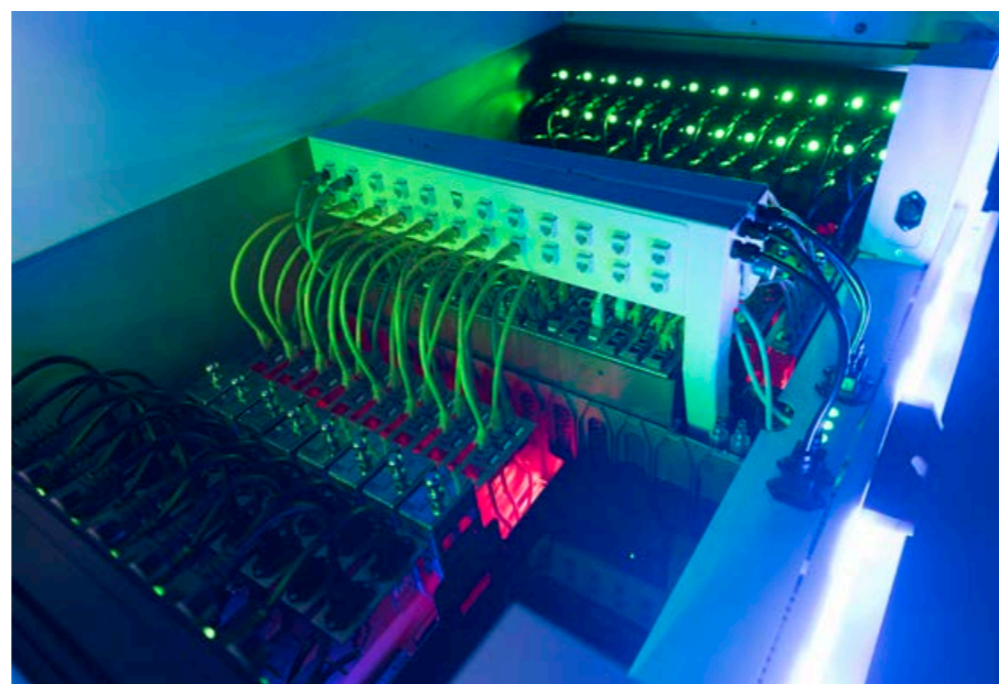
Vätskekyld server. Foto: Göteborg Energi
